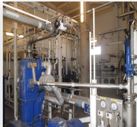
Figure 18: Station de production de \text{CO}_2 (Photos personnelle)
