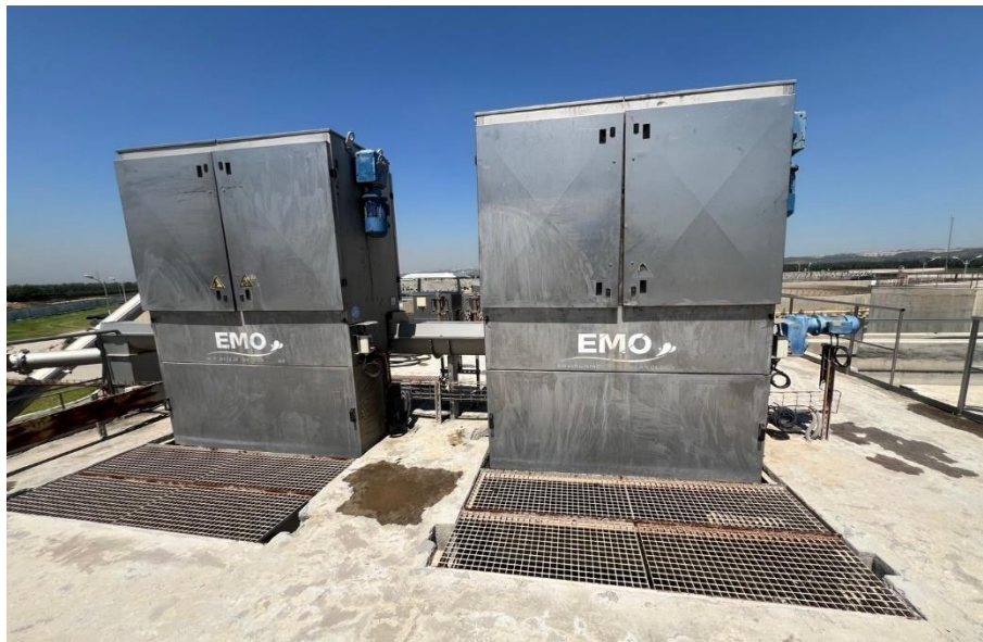
Figure 13: Les Dégrilleur fin de la STEP de Boufarik (originale, 2025).
