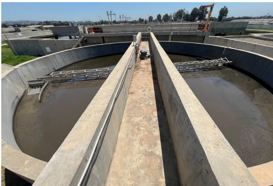
Figure 17: Dégazeur de la STEP de Boufarik (Originale, 2025).
