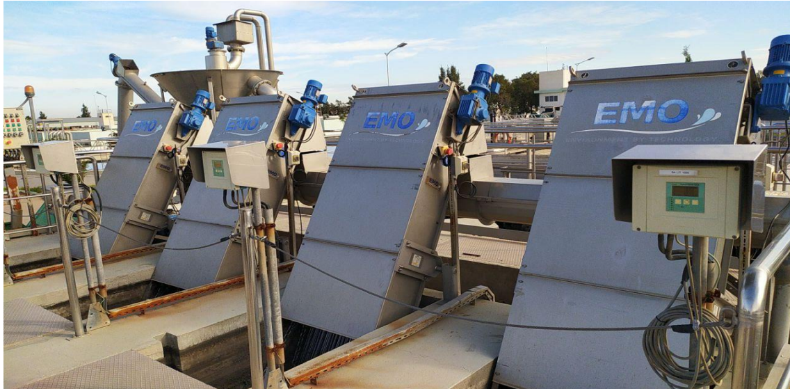
Figure 04: Les 4 dégrilleurs de la STEP de Beni Mered (Originale, 2025)
