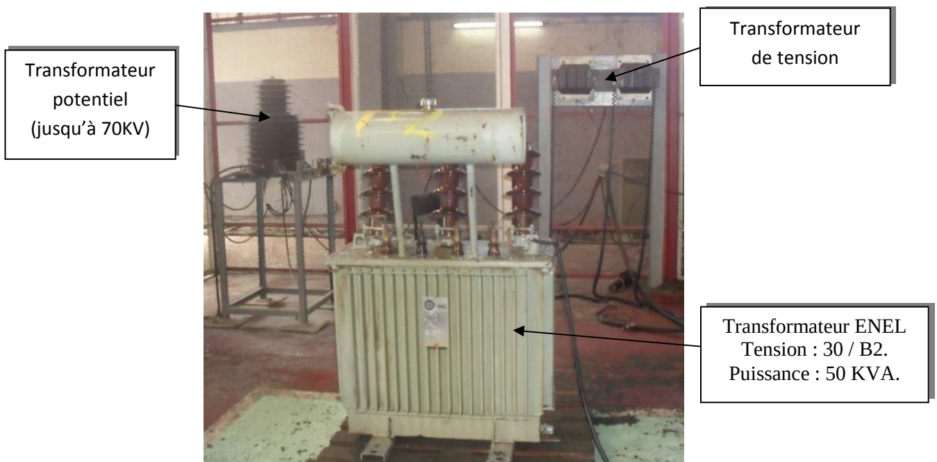
Figure II.1 : Transformateur sous contrainte électrique (banc d'essai)
