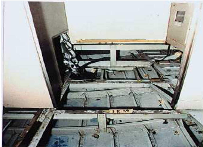
Figure (III-I) : La corrosion dans la zone de toilette
