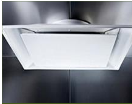
Le Système de climatisation
