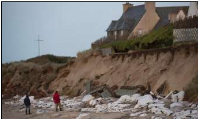
Fig.3 photos représente le phénomène d'érosion dans le littoral français ouest-france.fr640 x 360 www.googleimage.com
