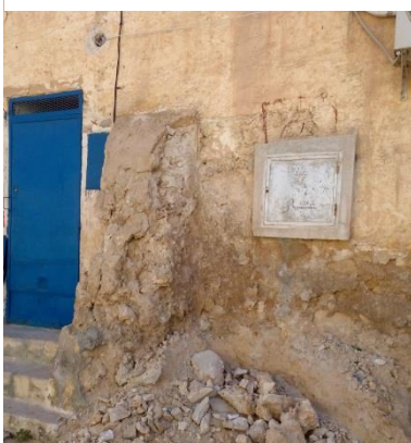
Figure 117: Contrefort dégradé. Source : Prise par l'étudiant.
