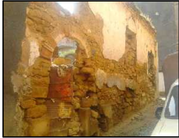
Figure 9: maison en ruine au niveau du tissu historique Source : auteur
