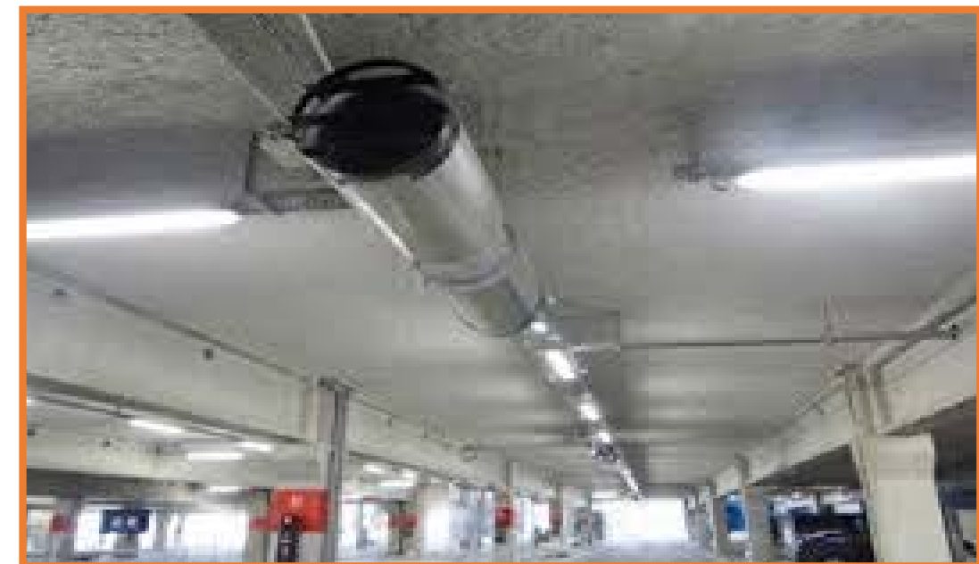
une ventilation mécanique
