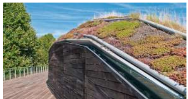
Fig.04.9. toiture végétale en pente. Source: PDF. Formation Bâtiment Durable : Toitures vertes: du concept à l'entretien Bruxelles Environnement.
