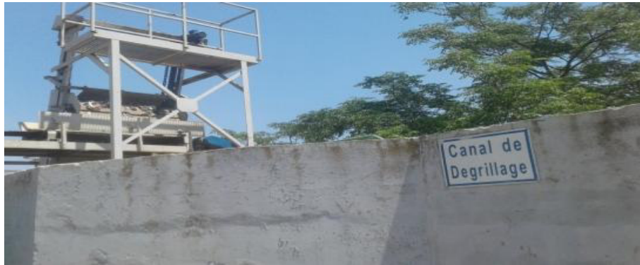
Figure 04 : Dégrilleurs grossier (Photo originale)
