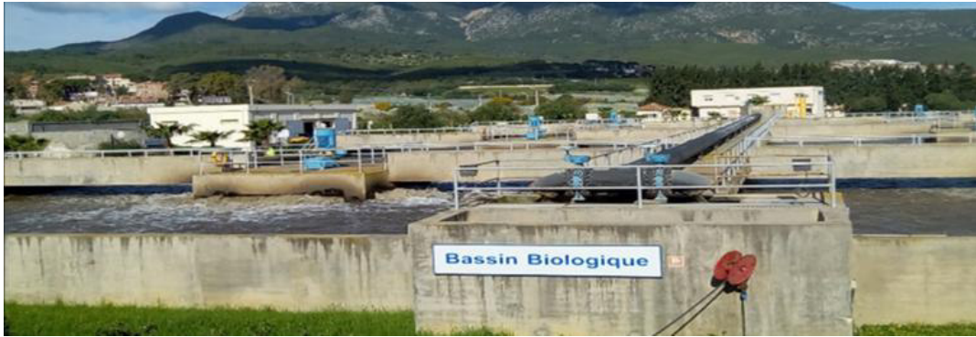
Figure 05 : Bassin biologique de la station de Chenoua (photo originale)
