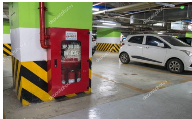
Figure : Type des équipements anti-incendie
