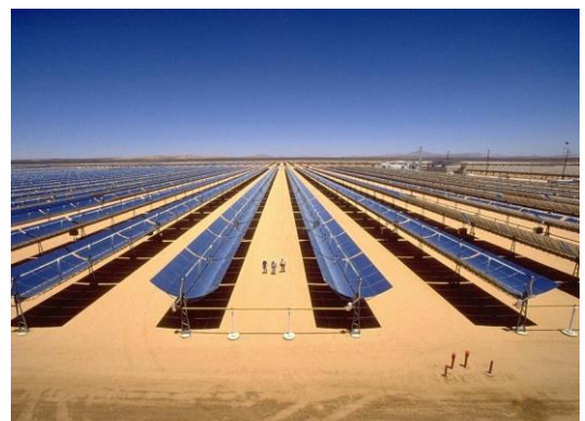
Figure 61 : Panneaux photovoltaïque. Source : Google image.
