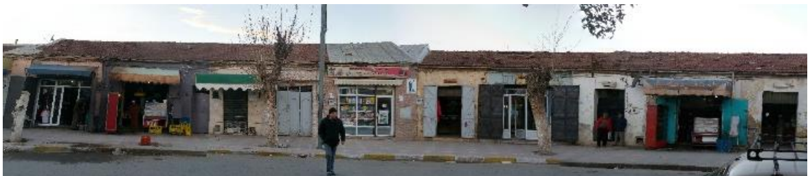
Figure 3.28 : Photo des façades vétustes (centre-ville) (Source : auteur)
