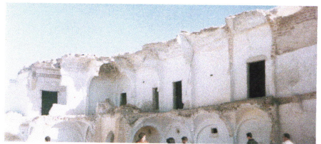
Fig 62 : etat de degradation de la Zaouia tidjania dans le centre de Guemar, source Auteur
