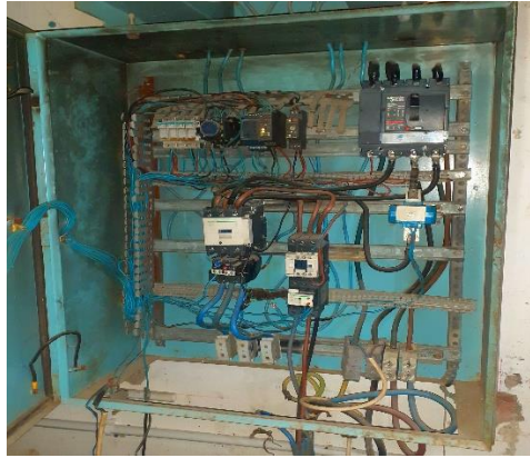
Figure III.6 : Armoire de commande du forage.
