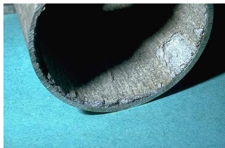
Figure 4 : corrosion feuilletant d'une canalisation en alliage d'aluminium véhiculant de l'eau [33].
