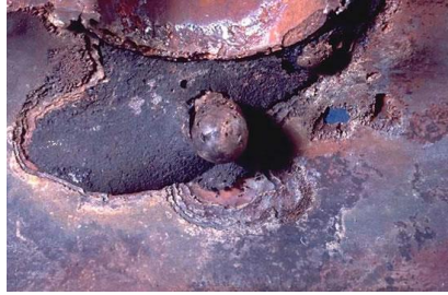
Figure 2: Corrosion galvanique au niveau d'une zone de brasage entre la brasure Cu-P et le tube en cuivre [33].
