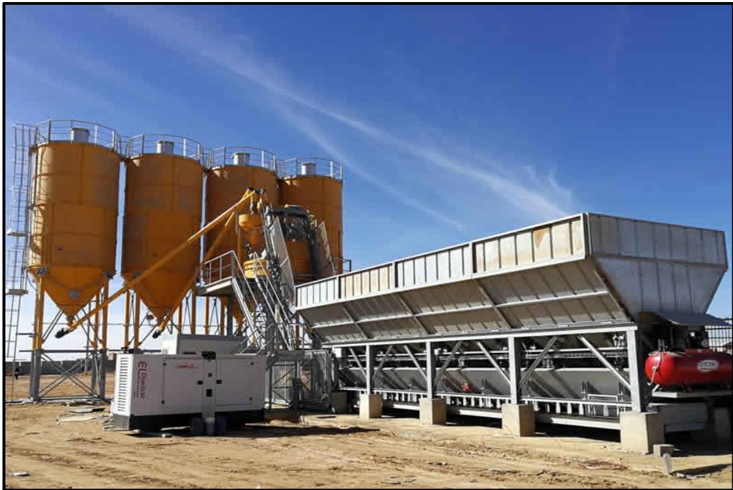
Figure 2-3: Centrale à béton horizontale
