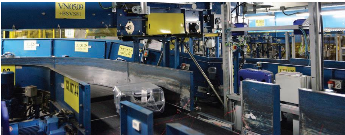
Figure 1.5 : BHS de l'aéroport de Malpensa [11]
