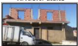
Figure 124 Façade mal traitée Source: Photo prise par les auteurs le 08/01/2019
