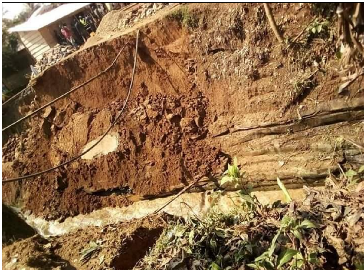
Figure 1.2 : éboulement de terrain en Algérie
