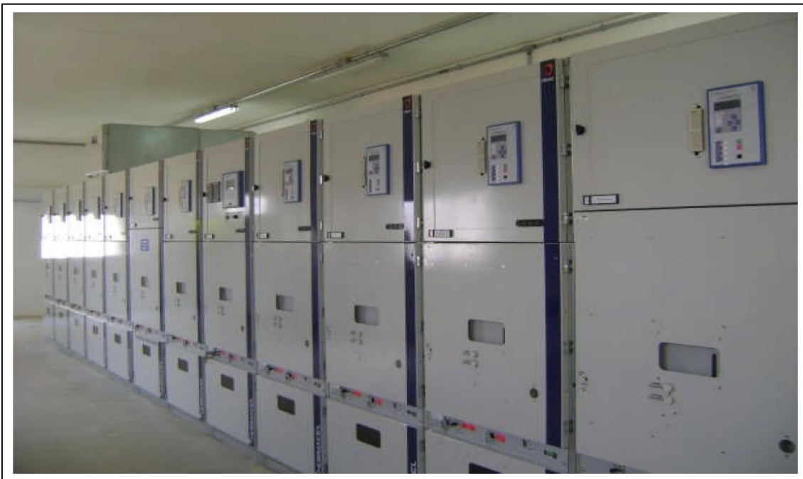
Figure I.6 : Cellules d'un Poste HTB/HTA [6].
