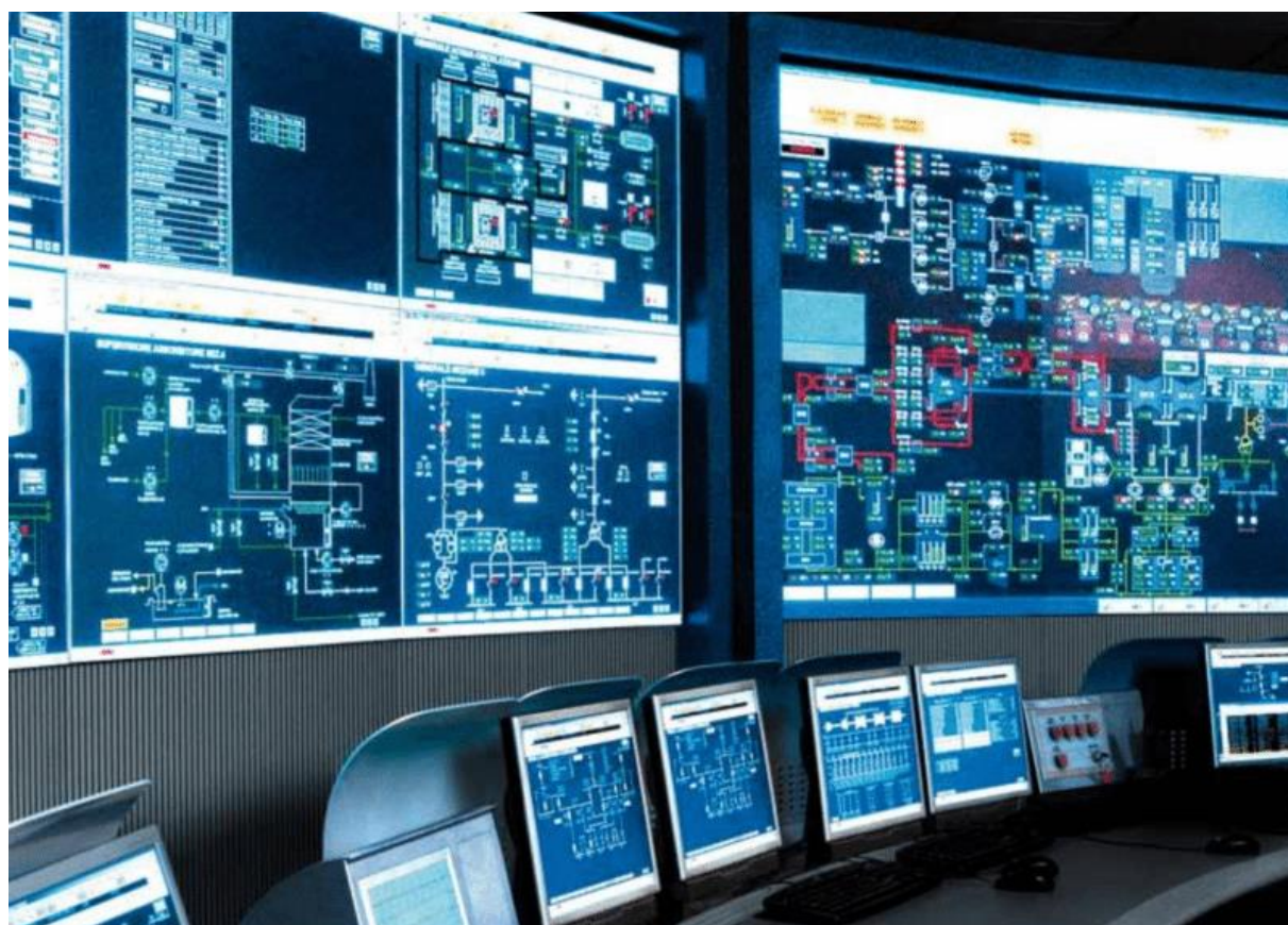
Figure II.1 : Vue de la salle de contrôle du dispatching (ou SCADA) [27].
