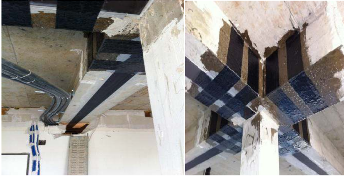
Figure I.27 : poutres en BA renforcées par matériaux composites.
