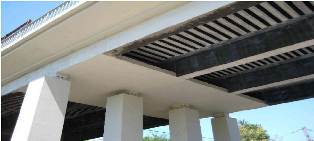
Figure I.28: tablier de pont en BA renforcé par matériaux composites
