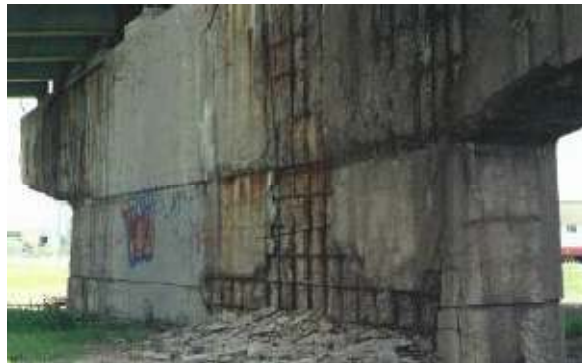
Figure I.7: Structure atteinte par l'attaque des chlorures
