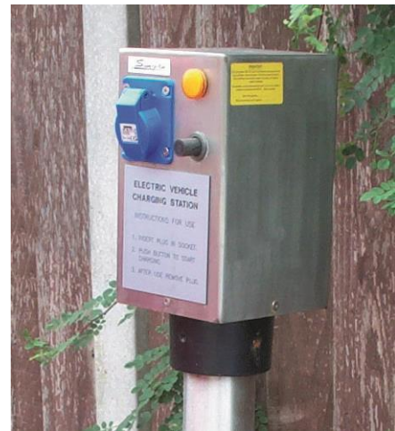
figure 10 : point de recharge pour la voiture électrique, source : https://www.flickr.com/photos/bioregional
