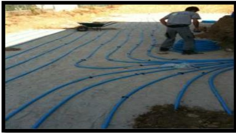
Fig171 : captage horizontal ; (Source : futures sciences 2015)
