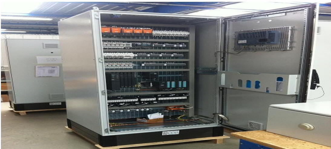
Figure 3.2. Exemple d'une Armoire de commande.
