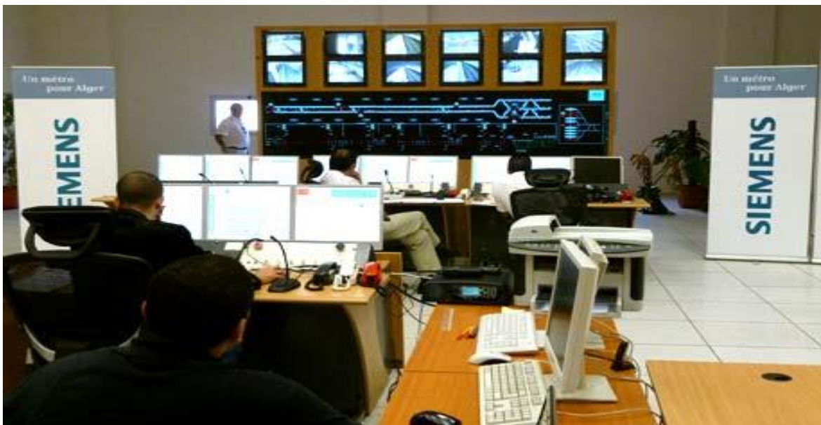
Figure 1.1. Salle de contrôle.
