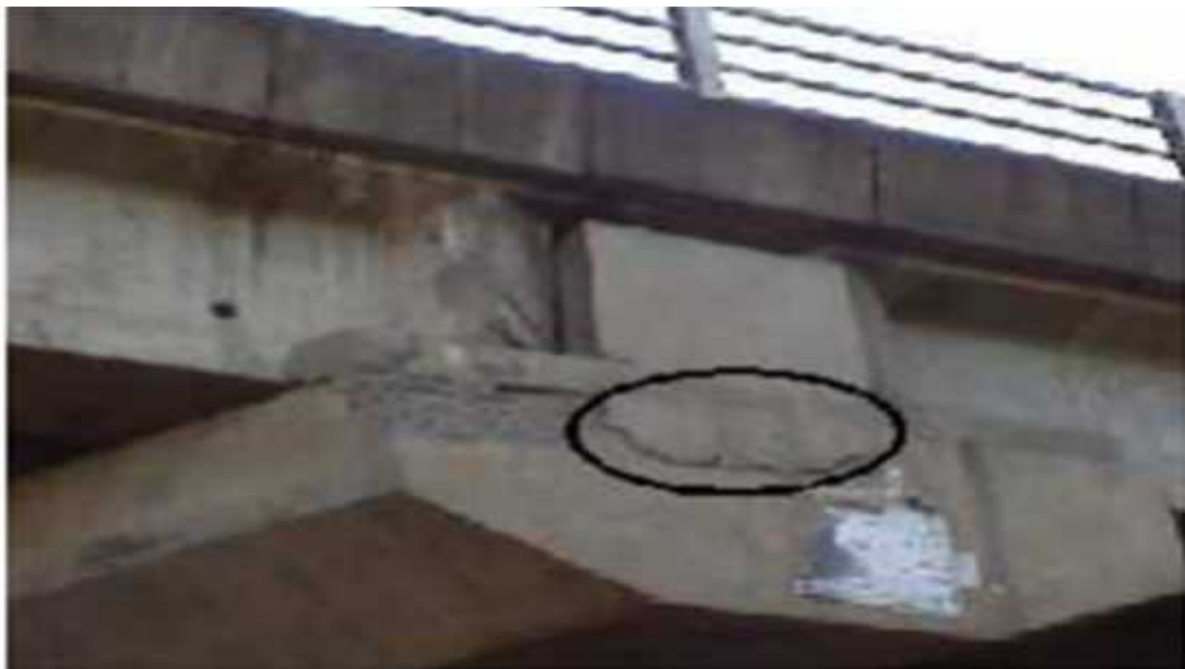
Figure I-41 : Epaufrure due par pression de corrosion [5]
