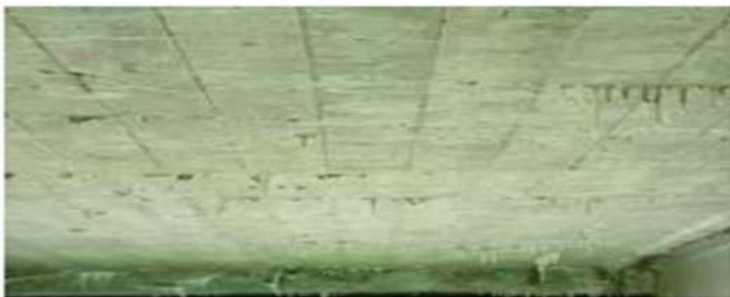
Figure I-39 : Efflorescence de dalle du pont [4]
