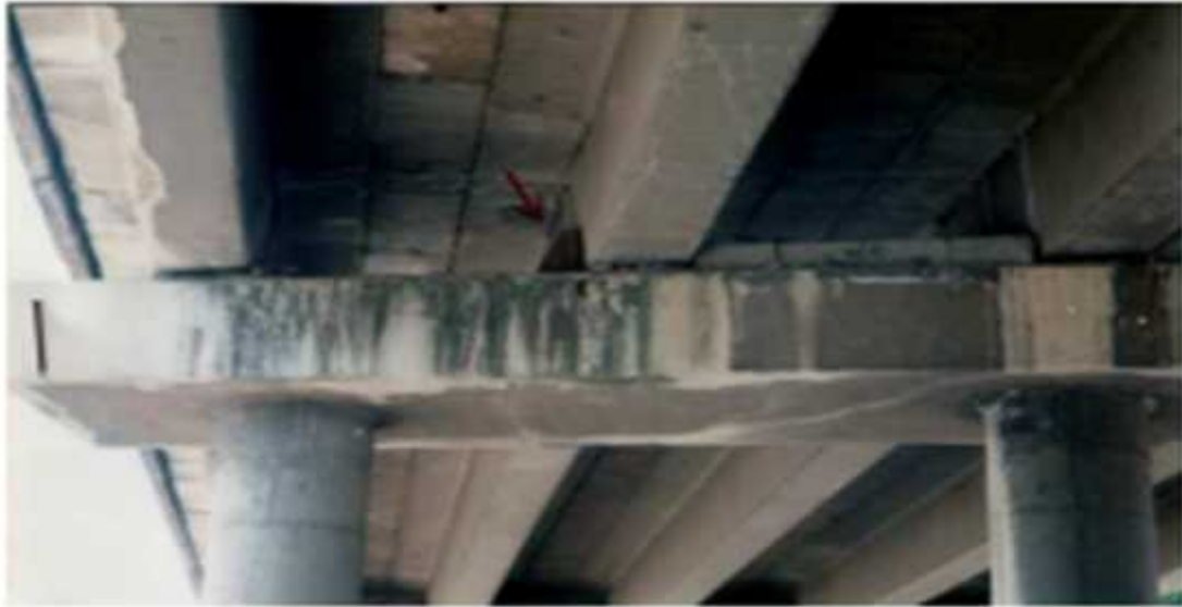
Figure I-40 : Efflorescence au niveau de chevêtre [4]
