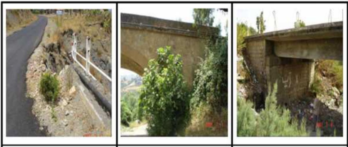
Figure I-51: Défaut présent aux niveaux des garde-corps et glissières de sécurité. [5]
