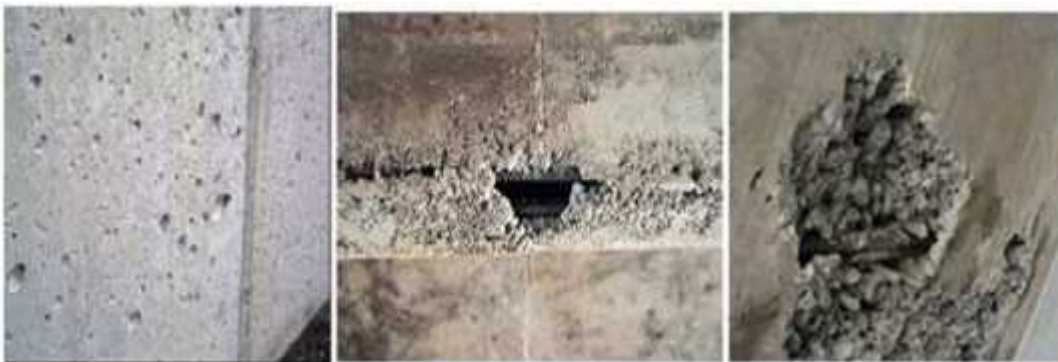
Figure I-45 : Défaut de mal exécution des travaux [5]
