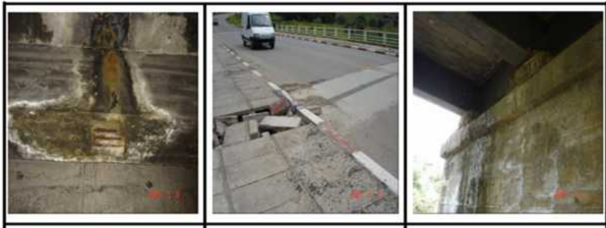
Figure I-49 : Défaillances observées aux niveaux des systèmes d'évacuation des eaux [5]
