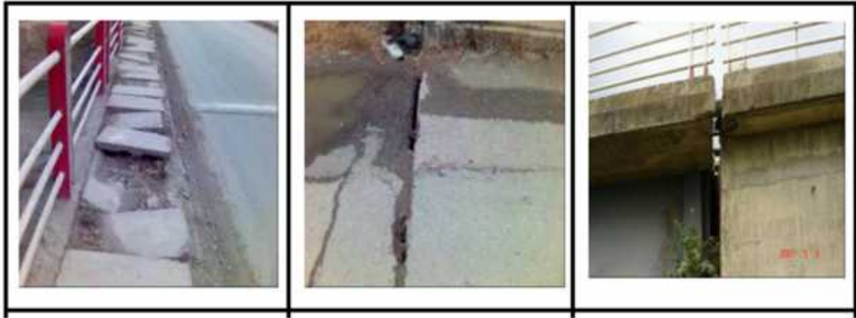
Figure I-50 : Défaut présent aux niveaux des joints de chaussée. [5]
