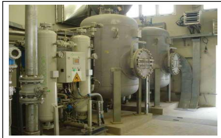
Figure 1.13 Station d'air comprimé.
