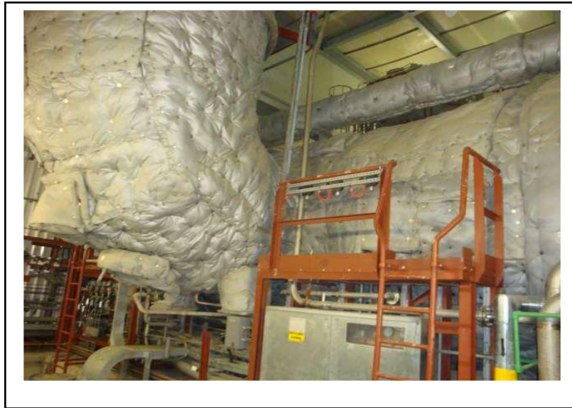
Figure 1.8 Turbine à gaz.
