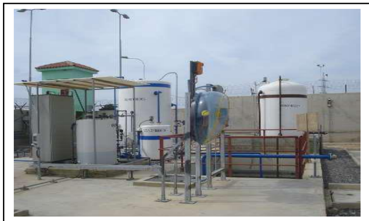
Figure 1.14 Station de traitement de l'eau.
