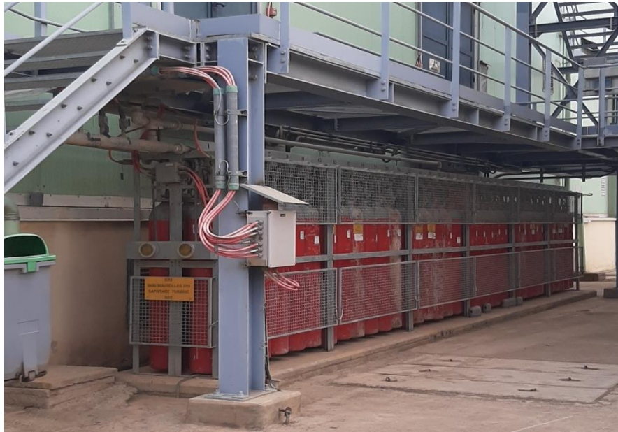
Figure 2.8 bouteille de CO2 du capotage turbine à gaz.
