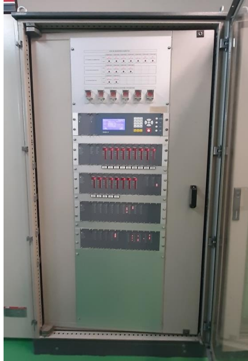
Figure 2.10 armoire de contrôle incendie 11cxu 01.
