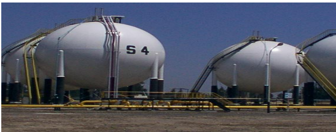
Figure 1. 3: Sphère de stockage des GAZ Raffinerie Liquide « propane et butane »
