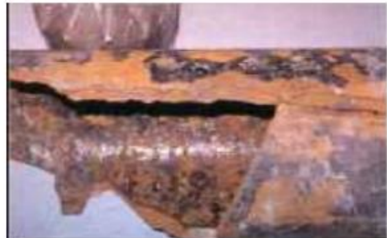
f. Corrosion généralisée.
