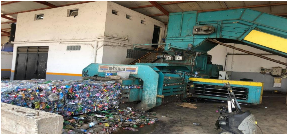
Figure V .5 : Photographie montrant la presse hydraulique et réception de balles 300 kg
