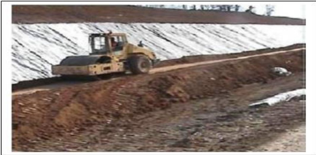
Figure I.31. l'utilisation du géotextile en jouant double rôle (drainage et renforcement du talus) [4]
