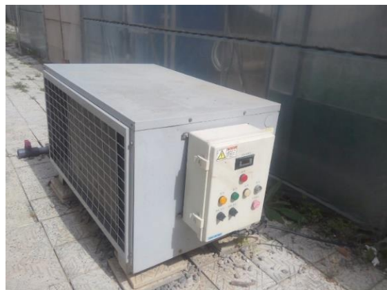
Figure 23 : Refroidisseur d'eau (Original, 2016)
