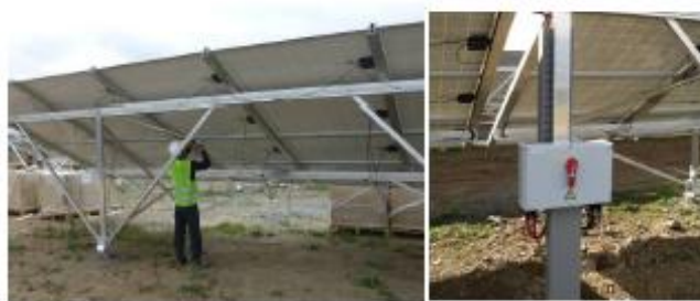
Figure I.7 : Centrale photovoltaïque de Puits Castan – Aude (Source EOLE-RES) A gauche : Câblage des panneaux – A droite : Boîtier de raccordement
