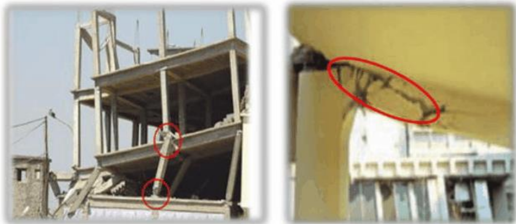
Figure 2.4 : Cas réel de rotules plastiques au niveau des poteaux et des poutres [21].
