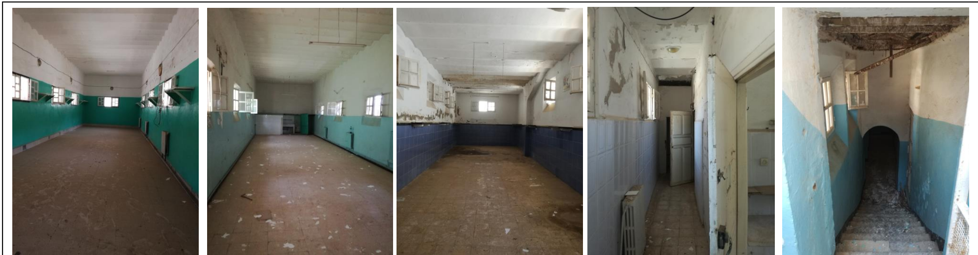
Fig 149 : La salle est du 1 ier sous-sol Fig 150: La salle est du RDC Fig 151: La salle ouest du 2 ème Fig 152: Les salles d'isolement Fig 153: L'escalier d'accès de la salle ouest du 2 ème sous sol
