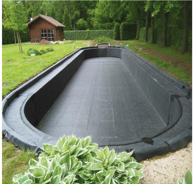
Figure 66 : La bâche en EPDM.
