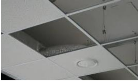
Figure 118: faux plafond Source : Google image
