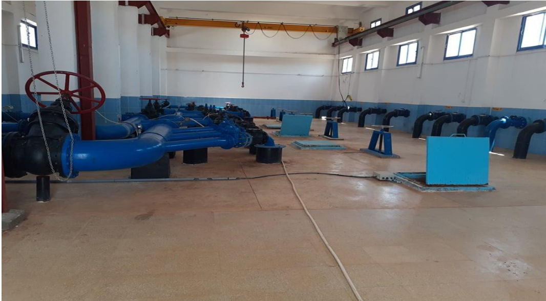
Photo 3.13. Station de pompage VSA Boumaaref
