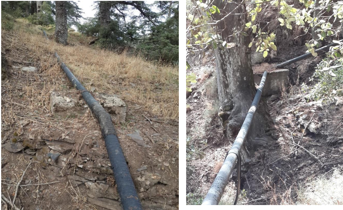
Figure III-6: Vue générale de l'état de la conduite de refoulement vers le réservoir trois moineaux [3]
