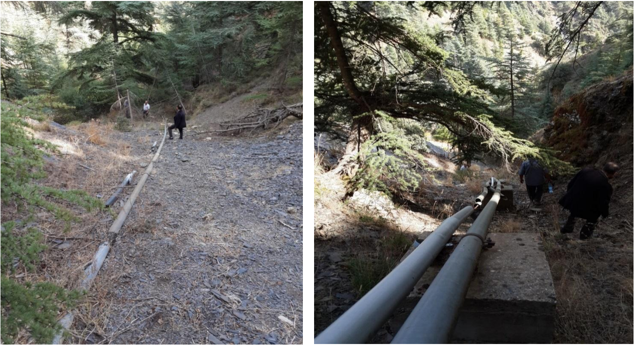
Figure IV-11 : Vue général de l'état de la conduite d'amenée de l'ouvrage de captage à la station de pompage
