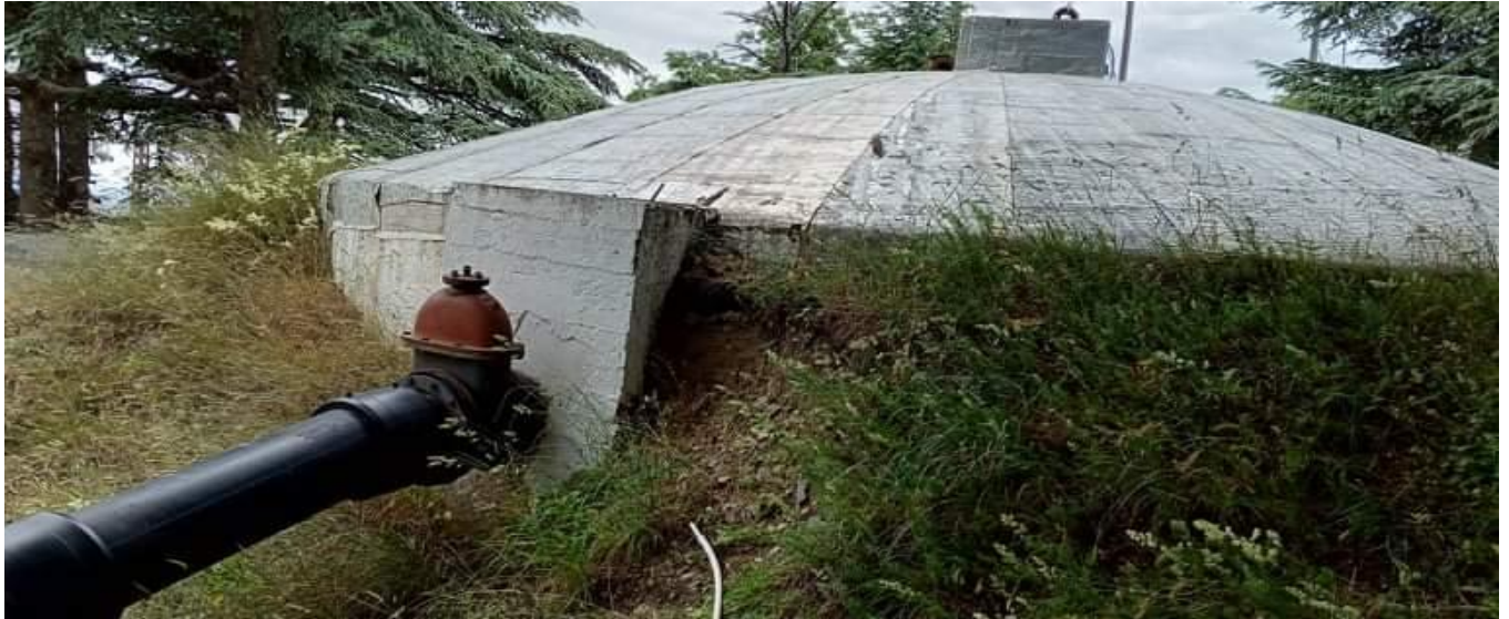
Figure III-2: Photo du réservoir principale « trois moineaux »
