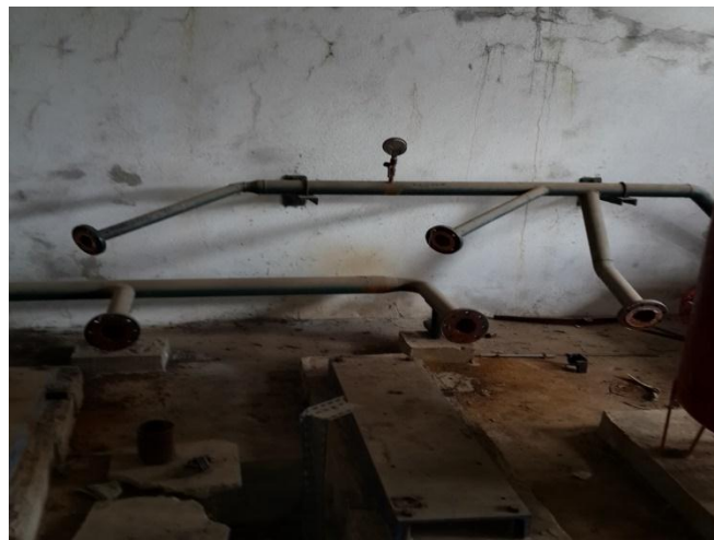
Figure III-8 : Vue conduite de refoulement en mauvais état
