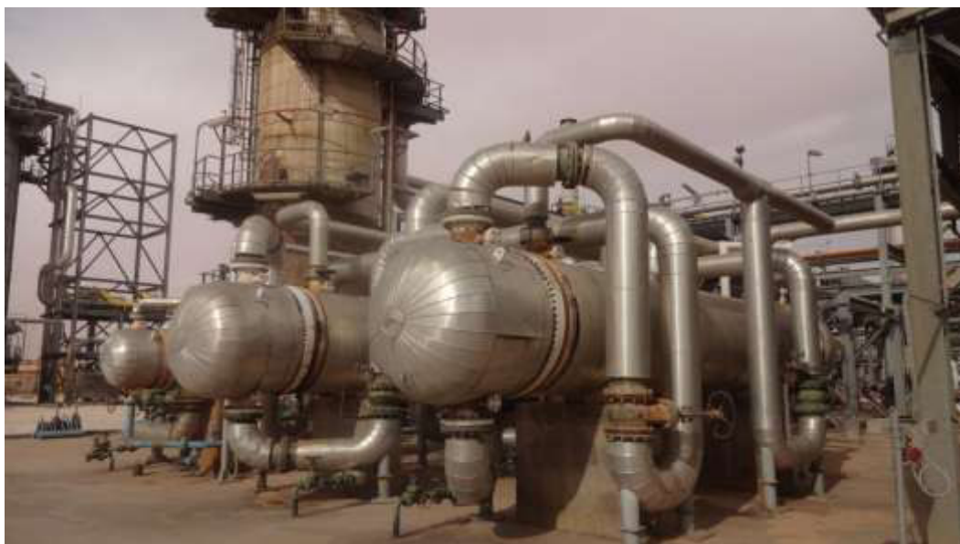
Figure (I.6) : Il y a trois échangeurs deux opérationnel et l'un de secours.
