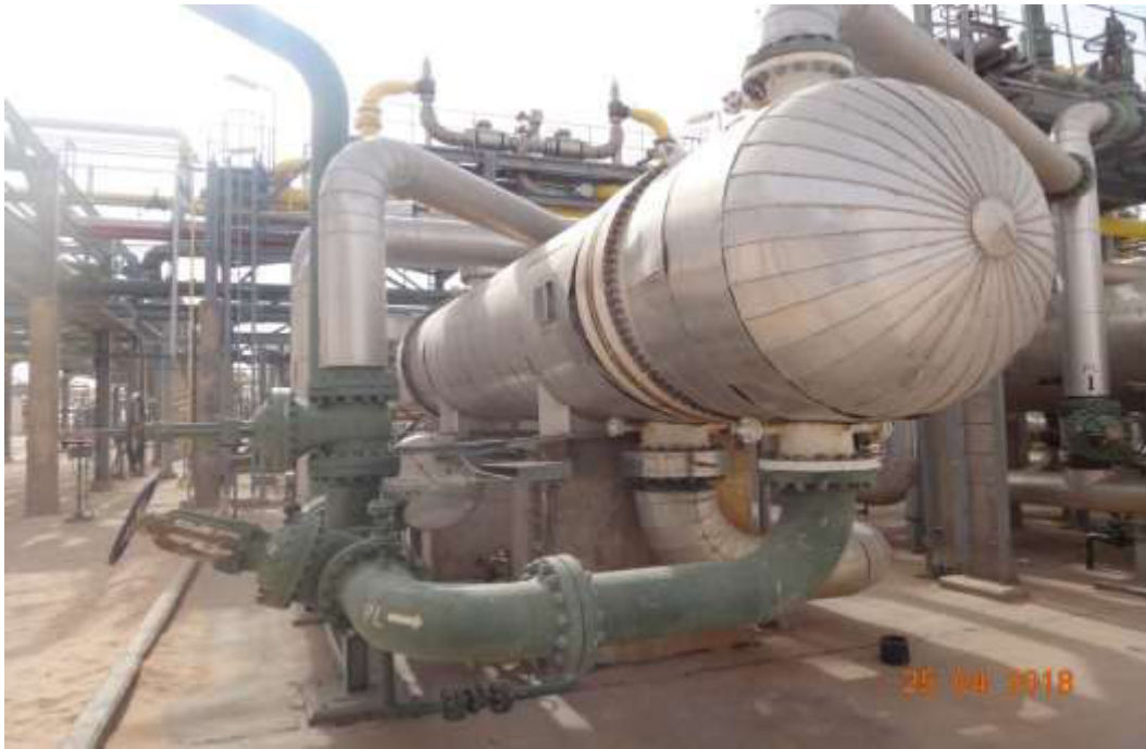
Figure (III.30) : Exemple d'un échangeur multitubulaires a tête flottante de Sonatrach (organisation Ourhoud) lieu de stage .
