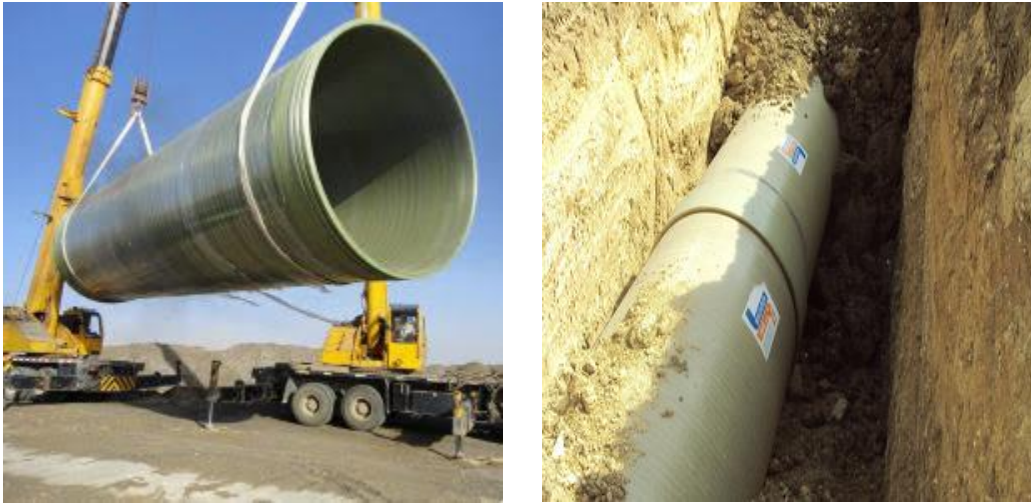
Figure 13 : Conduite en polyester renforcé de fibres de verre
