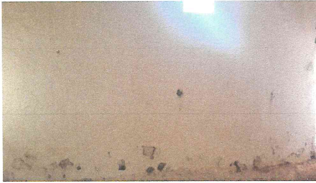
Photo 31 : Mur présent des trous.
