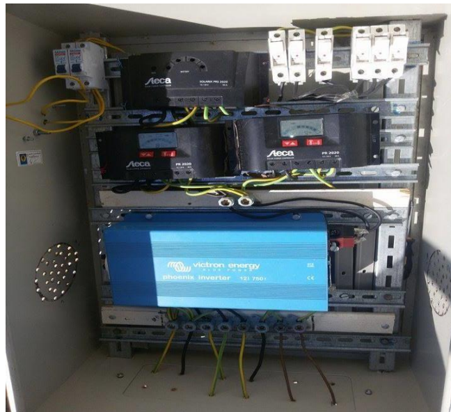
Figure VII.2 : Composants de l'armoire électrique
