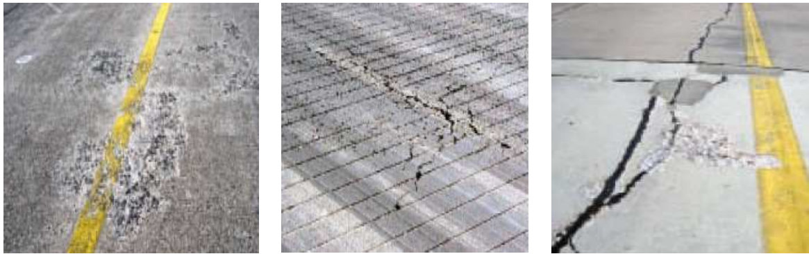
Figure 1.11 Le faïençage et l'écaillage dans les chaussées rigides
