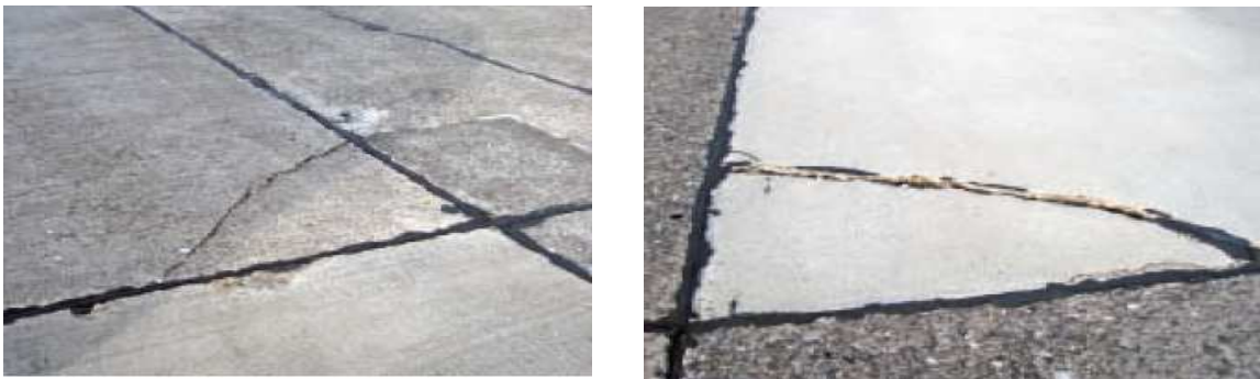
Figure 1.7 Les cassures d'angle dans les chaussées rigides
