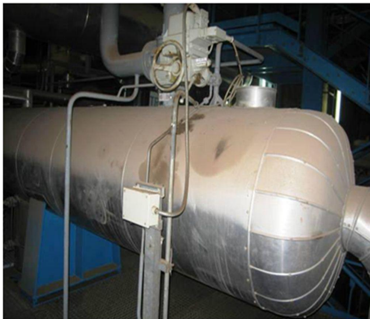
Figure I.10 Vue de réchauffeur basse pression (BP).
