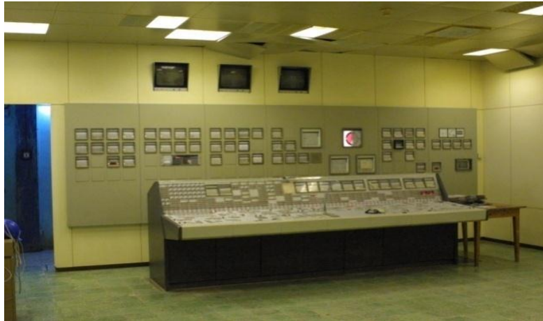
Figure I.11 Salle de commande
