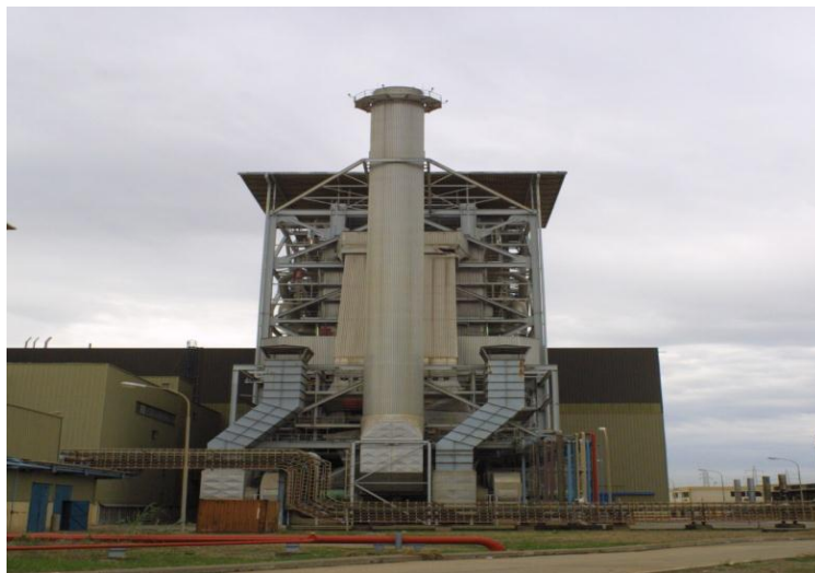
Figure I.5 Chaudière de la centrale de Cap Djinet
