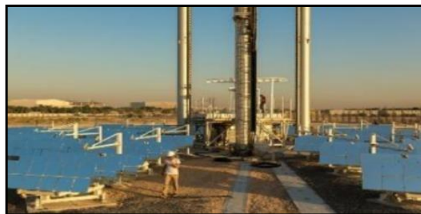
Figure 2.15 : Les panneaux photovoltaïques.
