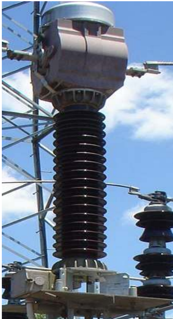
Figure1.14 : transformateur de courant
