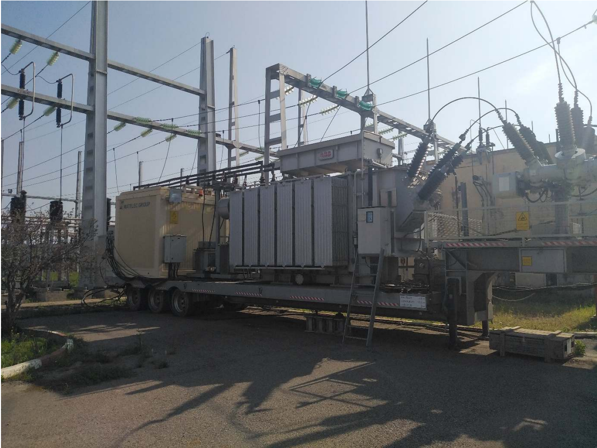
Figure1.11 : transformateur de puissance
