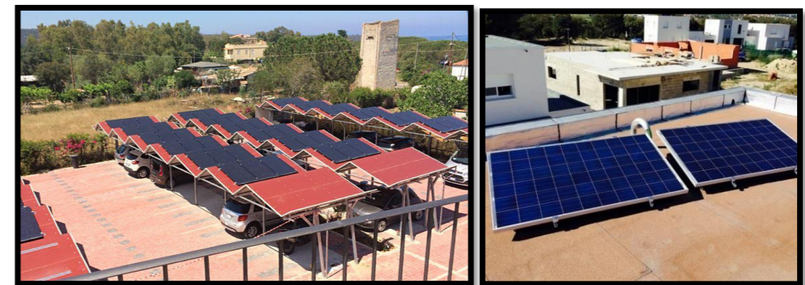
Figure 5.28 : panneau photovoltaïque. Source : Google image
