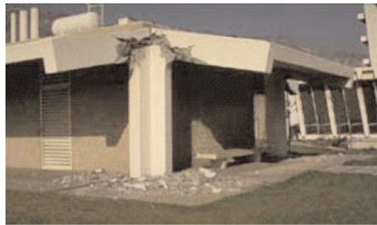
Fig.(I.7) : Rupture d'un auvent en porte-à-faux (Séisme de San Fernando, Californie, 9 février 1971)
