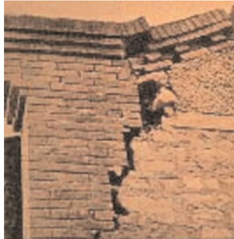
Fig (I.14) : Rupture d'un mur hétérogène (séisme de Tangshan, Chine, 28 juillet 1976)
