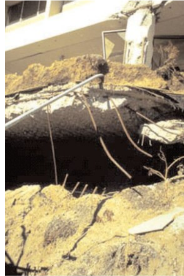
b) Toiture-terrasse végétalisée portée par des portiques en béton armé, dont les poteaux ont été cisailés
