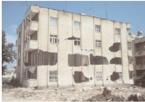
Fig(I.17) : Bâtiment endommagé lors de l'effondrement d'une construction voisine (déblayée avant la prise de la photo), séisme de Ceyhan- Misis, Turquie, 27 juin 1995
