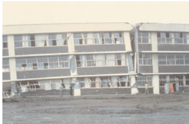
Fig.(I.13) : Dommages dus à l'entrechoquement de deux blocs de bâtiment séparés par un joint de dilatation thermique (séisme de Tokachi-Oki, Japon, 16 mai 1968)
