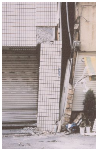
Fig(I.16) : Dommages dus à l'entrechoquement de bâtiments voisins (séisme de Kobé, Japon, 17 janvier 1995)
