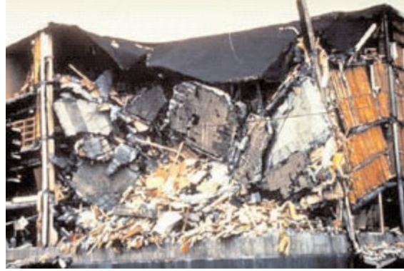
Fig(I.12) : Effondrement d'un bâtiment par torsion en raison d'une disposition asymétrique des murs assurant le contreventement (séisme d'Anchorage, Alaska 27 mars 1964)
