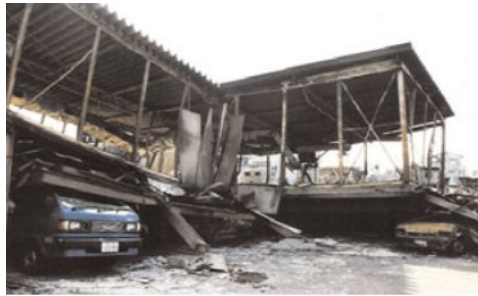
Fig. (I.10): Effondrement d'un bâtiment dont le rez-de chaussée n'était pas suffisamment contreventé (séisme de Kobé, Japon, 17janvier 1995)
