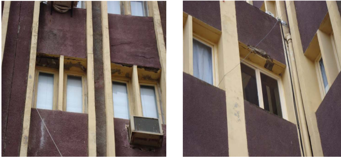
Figures 8 & 9 : Corrosion et dénudement des aciers des linteaux de fenêtres.
